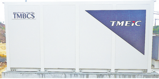
太陽光発電の短周期変動抑制のために導入されたTMEIC製リチウムイオンシステムTMBCSを収めたコンテナ
